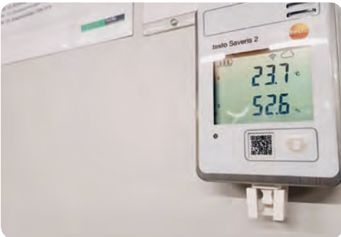
Installation einer permanenten Überwachung des Raumklimas mit Alarmfunktion.
