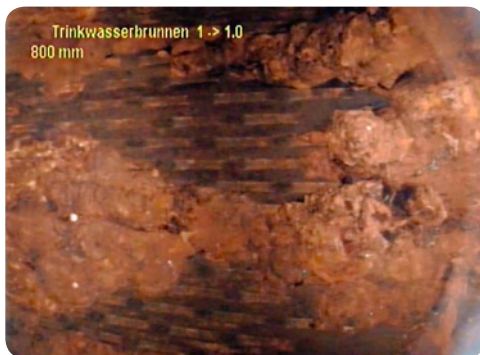
Zustand, wie der Brunnen vor der Reinigung aussah
